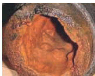
Vervuiling in de leiding.
